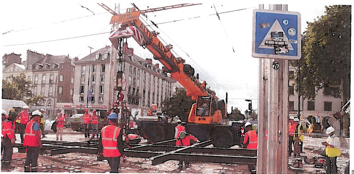
Le groupement ETF-Colas Rail a réalisé et livré en deux blocs un énorme croisement en acier long de 10 mètres et pesant 14 tonnes.
